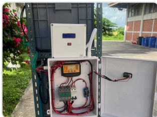
ตู้ควบคุมของเครื่องบำบัดน้ำเสีย พร้อมตัวควบคุมการชาร์จจากแผงโซลาร์เซลล์
