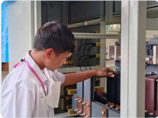
ตรวจงานในตู้ไฟฟ้าที่มีบัสบาร์ทองแดง
