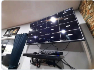
ติดตั้งวิดีโอวอลล์หลายจอ
