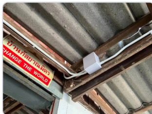
กล่องพักสายบนโครงหลังคา
